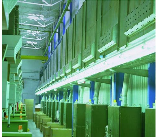
Diffusori d'aria tipo LTB, montati direttamente sul canale di mandata, ventilazione dal lato
