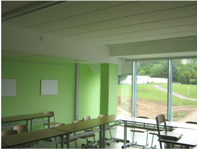
Ansicht des Deckenkoffers mit eingebautem LTG Lüftungsgerät
